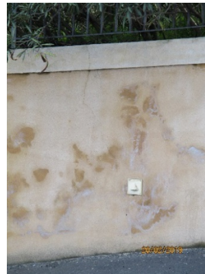
Foto 2: Danni su muretto di recinzione
