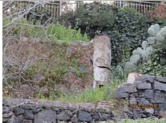
Foto 2: Danni su manufatti circostanti edifici
