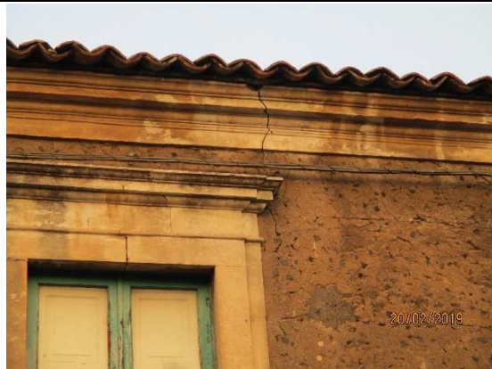
Foto 2: Danni su manufatti
