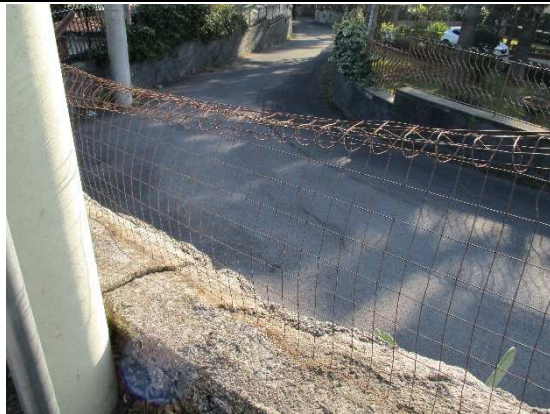
Foto 1: Danni su manufatti e sede stradale
