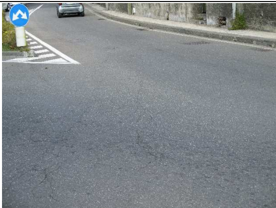
Foto 3: Fratturazione su sede stradale
