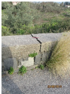
Foto 3: Danni su manufatto stradale
