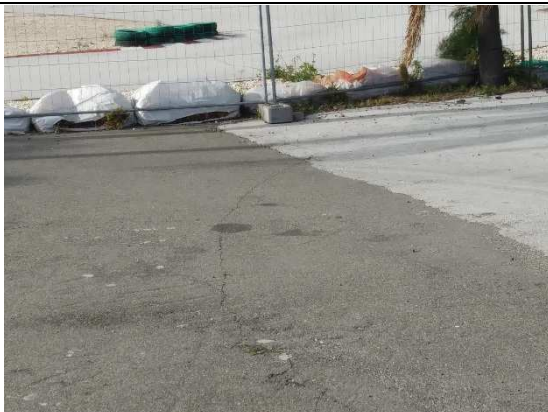
Foto 3: Fratturazioni (particolare) che si propagano oltre recinzione
