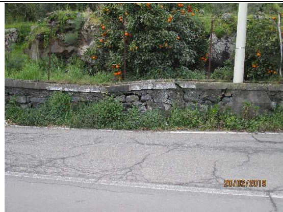
Foto 2: Danni su muretto con deformazione
