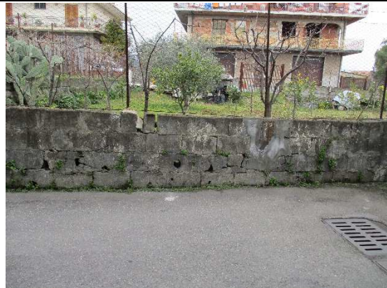
Foto 2: Lievi danni su muretto di recinzione
