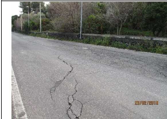
Foto 1: Fratturazione su sede stradale
