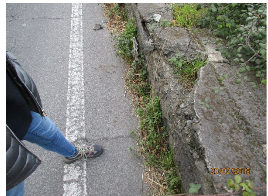
Foto 4: Fratturazione su sede stradale e sul muretto
