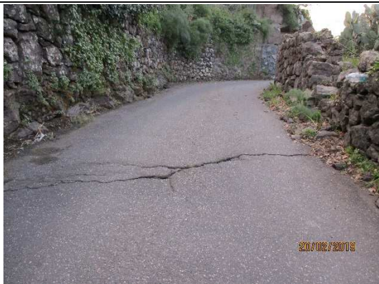
Foto 3: Fratturazione su sede stradale via Trigona
