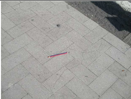
Foto 1: Fessurazioni sul marciapiede lungo il cimitero
