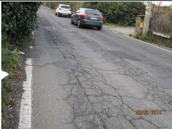
Foto 3: Fratturazione su sede stradale
