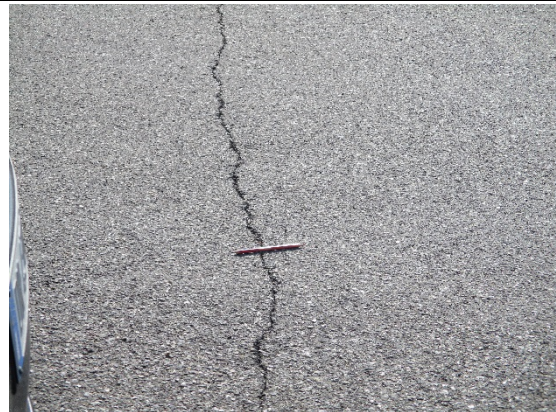
Foto 2: Fratturazione su sede stradale nel piazzale foto 3
