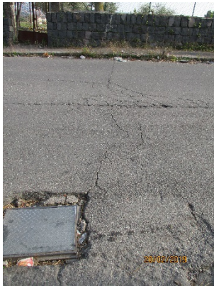
Foto 1: Fratturazione su sede stradale e danni su muretto
