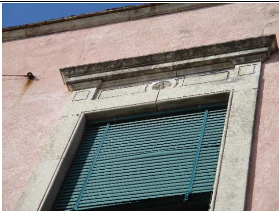
Foto 3: Danni su edificio
