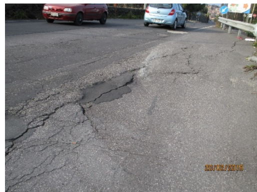
Foto 4: Particolare fratturazione su sede stradale
