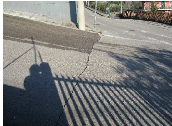
Foto 3: Fratturazione su sede stradale in via Alessandria
