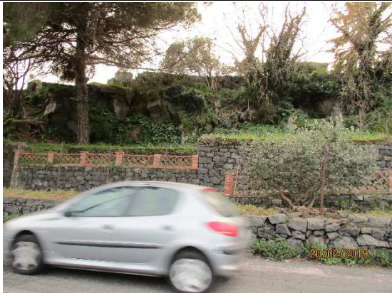
Foto 1: Scarpata di faglia con fratturazione
