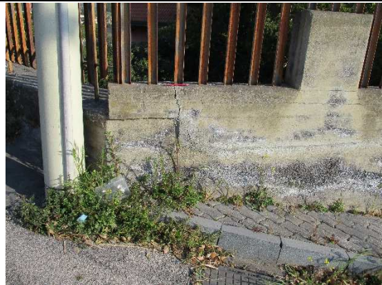
Foto 2: Danni su muretto in via Alessandria
