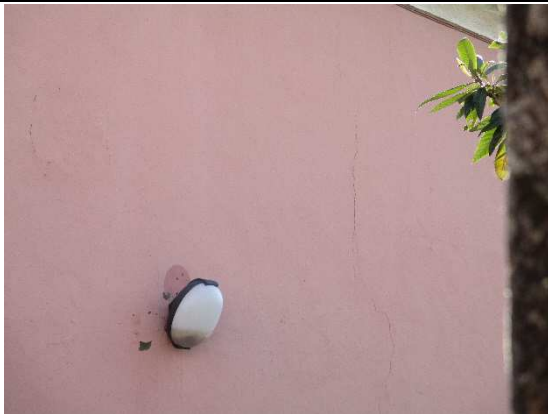
Foto 1: Danni su edificio
