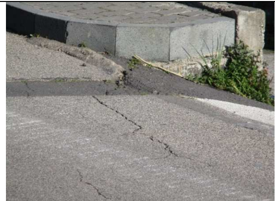
Foto 4: Fratturazione su sede stradale in via Monte Bianco angolo via Ande
