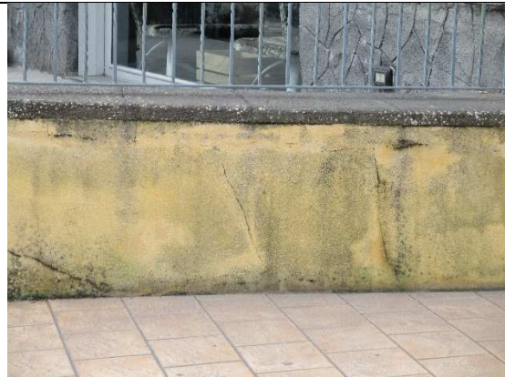
Foto 2: Danni su muretto
