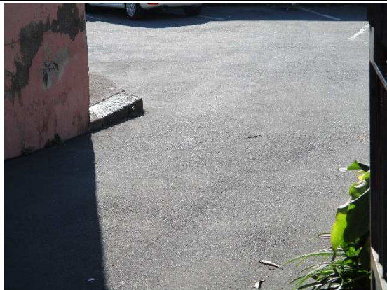
Foto 2: Fratturazione su sede stradale rif. edificio foto 1
