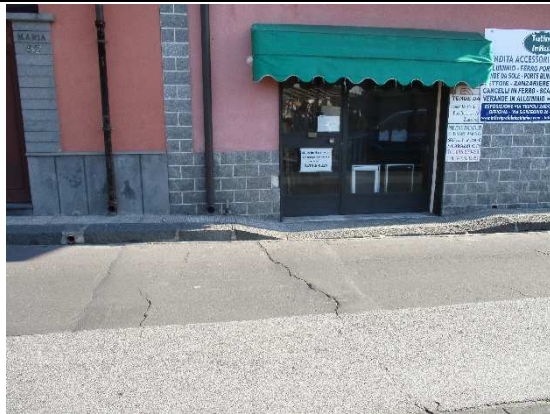
Foto 1: Via Macello danni su sede stradale ed edificio
