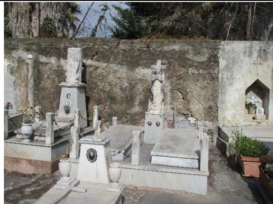
Foto 2: Danni su muro di recinzione all' interno cimitero
