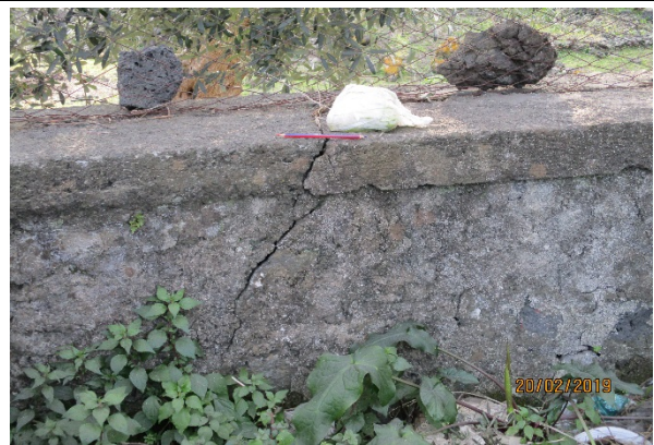
Foto 4: Danni su muretto
