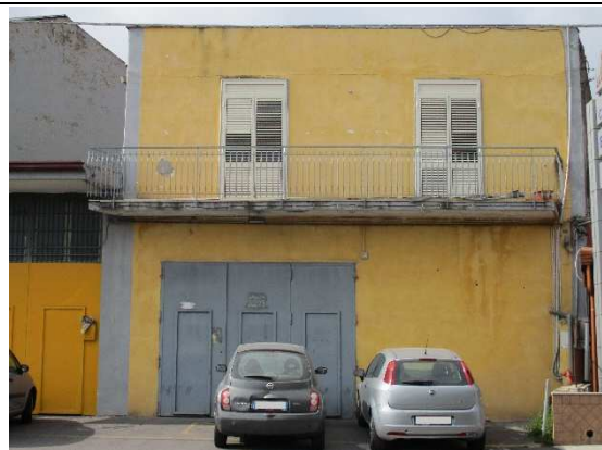
Foto 4: Danni su porzione superiore edificio
