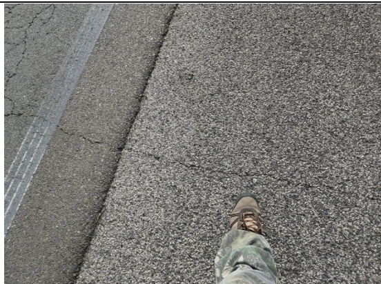
Foto 4: Fratturazione su sede stradale adiacente il Kartodromo
