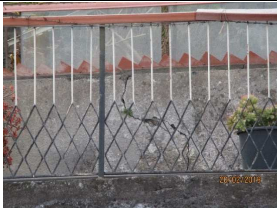
Foto 1: Danni su manufatti
