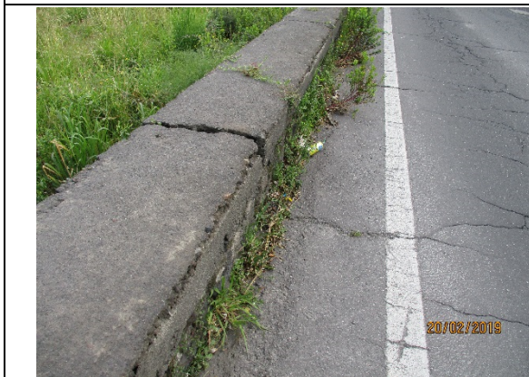
Foto 3: Fratturazione su sede stradale estese, con danni, al muretto
