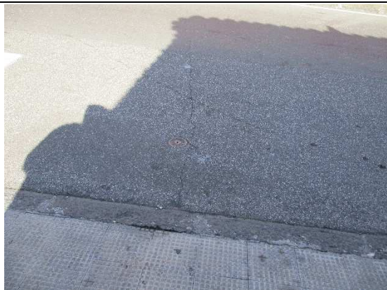
Foto 4: Fratturazione su sede stradale
