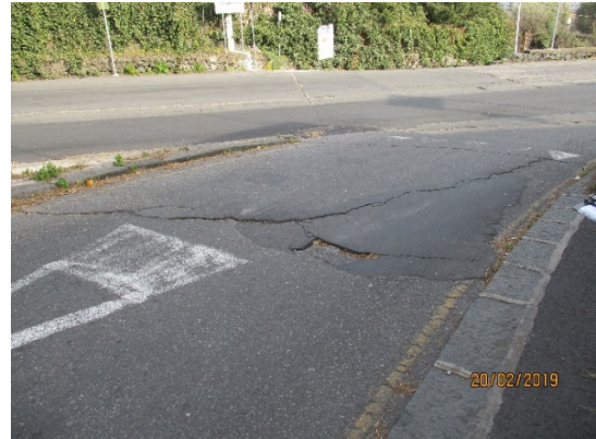
Foto 2: Fratturazione su strada pressa spartitraffico
