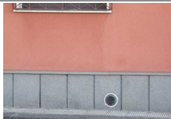
Foto 4: Danni su edificio
