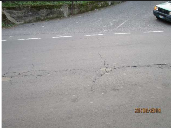
Foto 1: Fratturazione su sede stradale via Fisichelli
