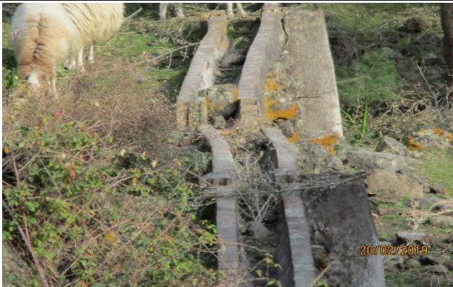
Foto 3: Danni su manufatti, si noti la dislocazione
