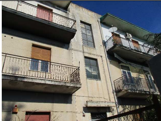
Foto 1: Lesioni estese su prospetto edificio
