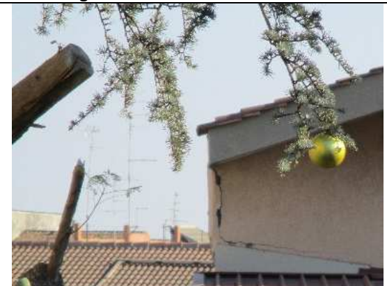
Foto 4: Dettaglio della foto 3 con evidente lesione
